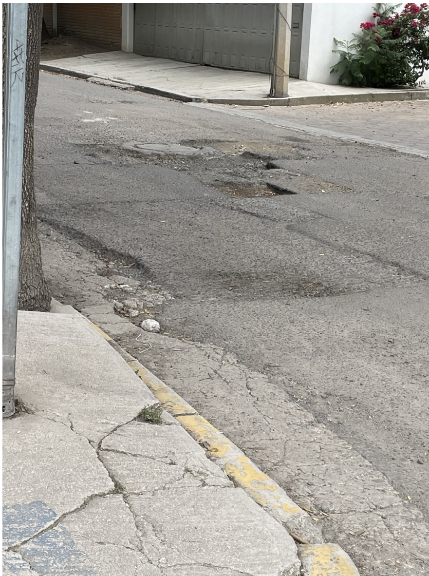
Vialidad y banqueta con deterioro visible en una calle próxima al Centro Histórico.
